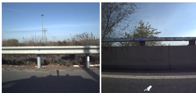
高速路护栏螺栓脱落进行识别
