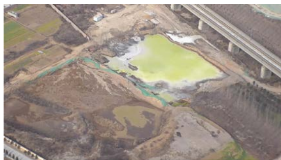
无人机在进行生态环境保护巡检中发现的工地污水偷排问题
