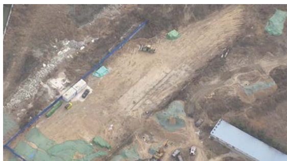
无人机在进行生态环境保护巡检中发现的工地违规施工问题
